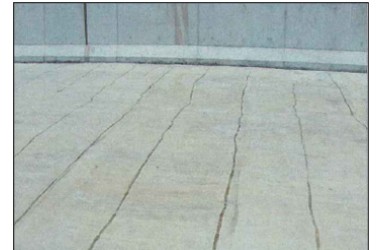
床版上のひびわれ
